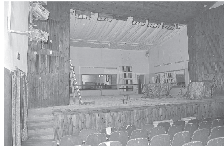
...и зал ожидающий ремонта
